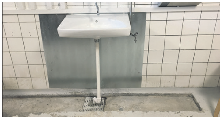
Det oprindelige afløb til vaskemaskinerne.
