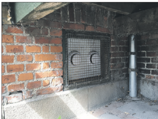
Dampudledningen under Anna Marie Houmanns veranda.
