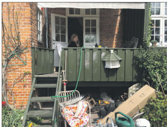
Verandaen, hvor dampen udledes fra muren under trappen.
